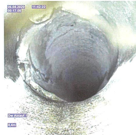
H 01_0a6bfa87-aead-48f1-8701-e63939e178cd_20200807_103 925_278.jpg, 00:00:14, 8.30m Verschobene Rohrverbindung, versetzt, Versatz: 10mm von 6 Uhr bis 12 Uhr / Riss
