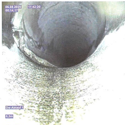
H 01_0fe04c11-9231-48c2-8bee-369df8dbef65_20200807_1039 17_507.jpg, 00:00:14, 8.30m Verschobene Rohrverbindung, versetzt, Versatz: 10mm von 6 Uhr bis 12 Uhr / Riss
