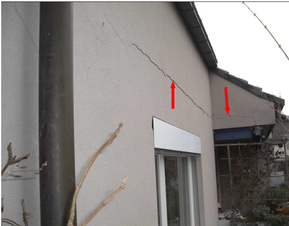
Abb. 8: Fassadenriss Brüstung Terrasse DG
