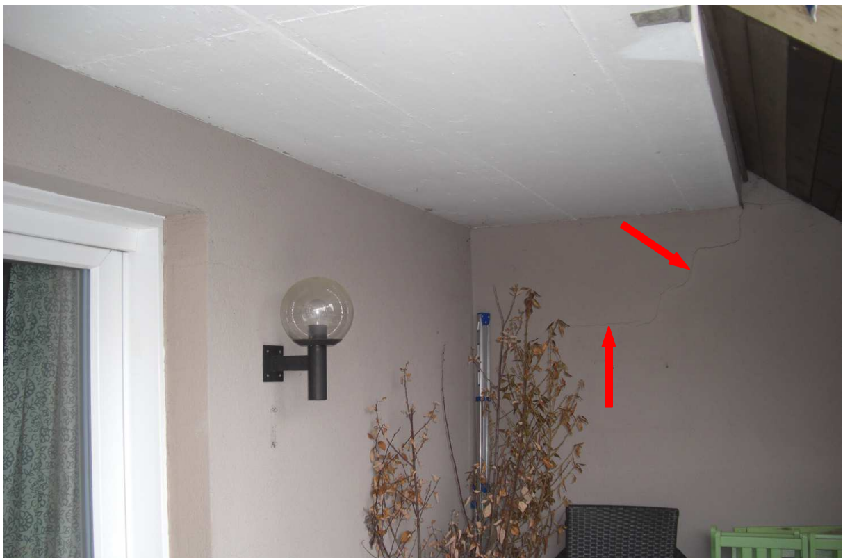
Abb. 10: Ansicht Riss Gebäudetrennwand Bereich Terrasse Dachgeschoss
