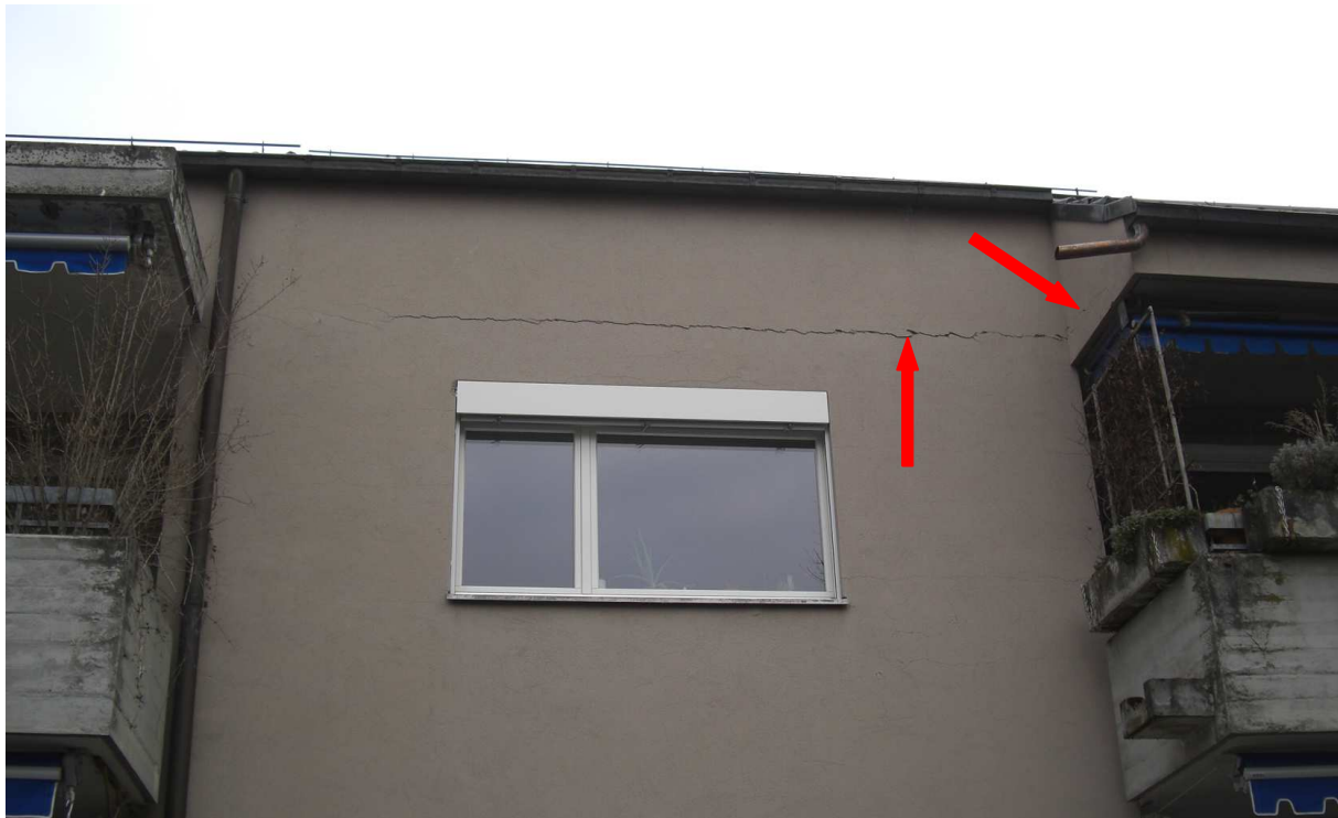
Abb. 7: Fassadenriss Brüstung Terrasse DG
